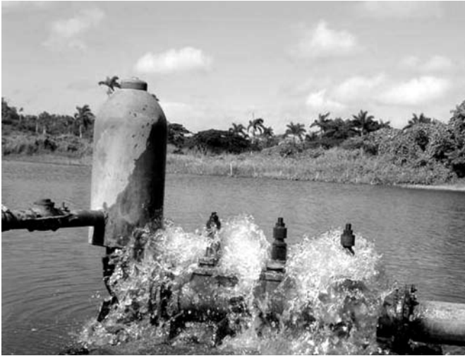
Uso de fuentes de energía alternativa, Ariete Hidráulico. Provincia Sancti Spiritus
